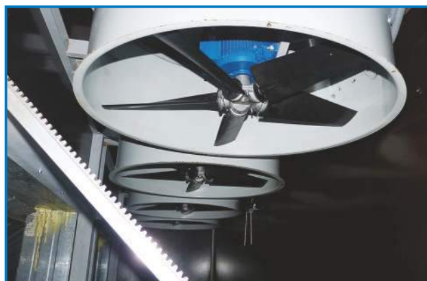
Установленные в модульной вентиляционной камере мощные напорные вентиляторы соединены с направленными воздуховодами.
