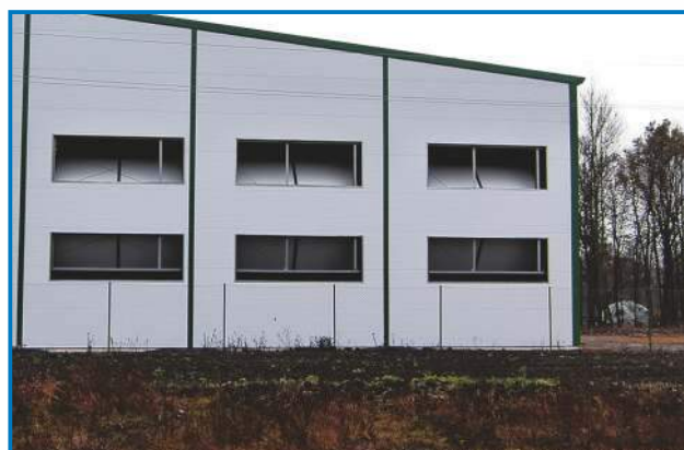
Так выглядят клапаны снаружи овощехранилища – приточный (снизу) и выбросной (сверху).
