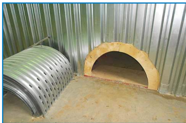
Отверстие вентиляционной камеры, к которому подстыковываются воздуховоды.
