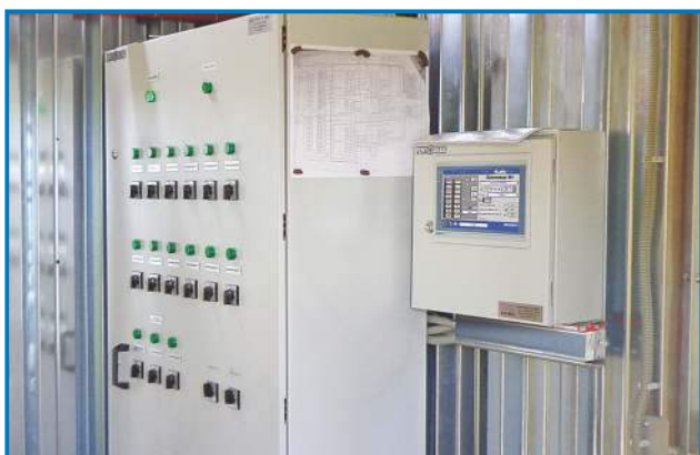
Блоки управления и автоматизации VENTOGLAS™ в длинном овощехранилище с двумя каналами подачи воздуха.
