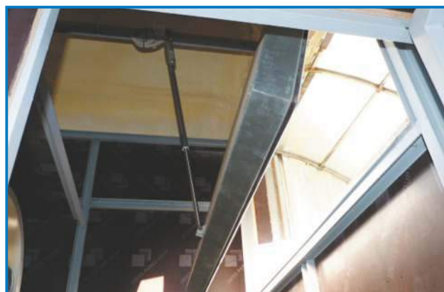
Приточный клапан смонтирован в МВК для овощехранилища навалного типа.
