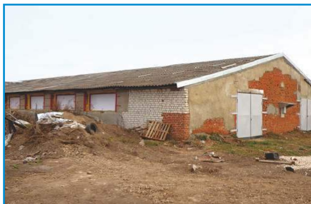
Реконструированное хранилище с установленной вентиляционной системой VENTOGLAS.
