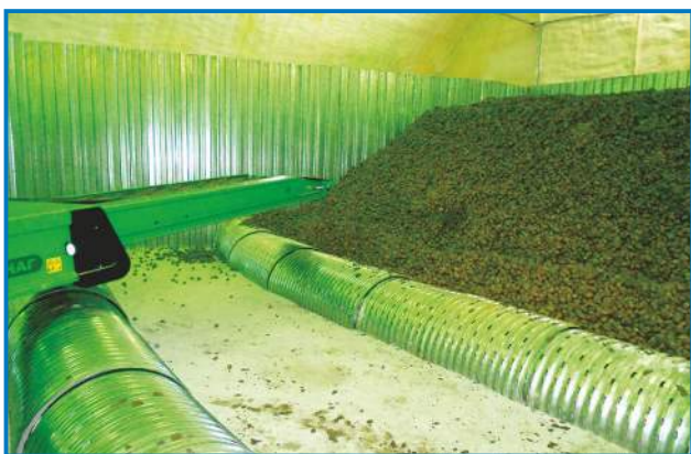
Картофелехранилище навалного типа с установленными вентиляционными каналами VENTOGLAS™.
