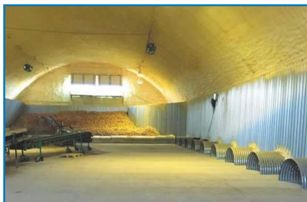
В этом лукохранилище навалного типа, тоже установлена вентиляционная система VENTOGLAS™.
