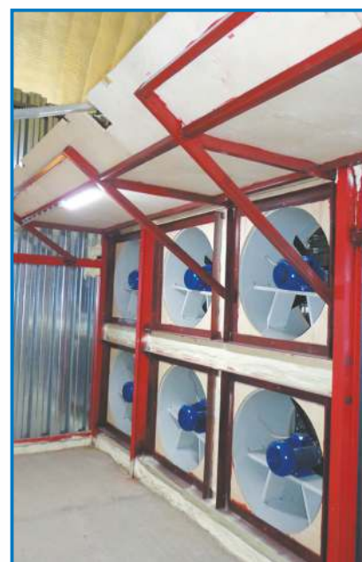
Блок напорных вентиляторов установленных в камере смешивания
