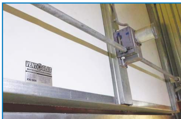
Мощный редуктор, установленный на приточном клапане, способен открывать и закрывать устройство в любую погоду.
