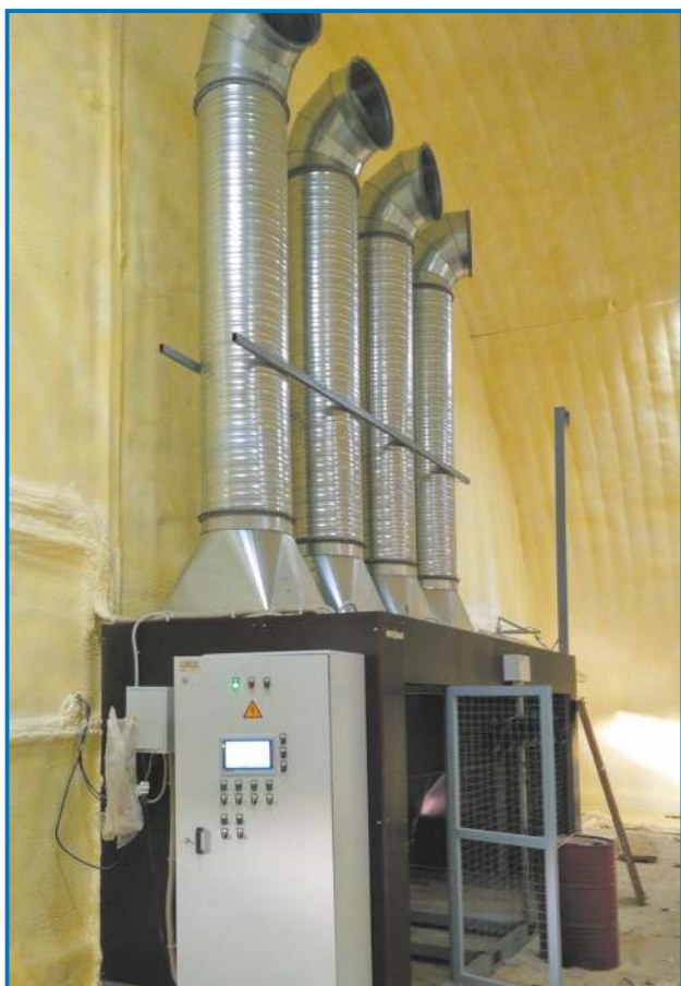
Шкаф (блок) управления VENTOGLAS™ установлен в хранилище, рядом с модульной вентиляционной камерой.
