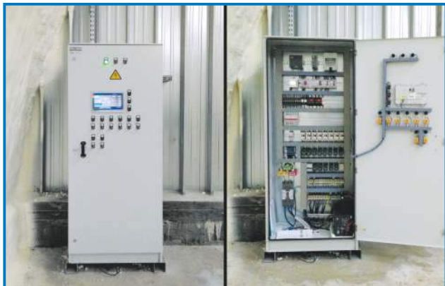
Шкаф управления VENTOGLAS™, установлен в картофелехранилище навального типа.
