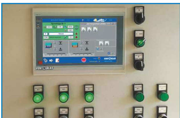
Управление вентиляционной системой VENTOGLAS™ располагается на двери шкафа.
