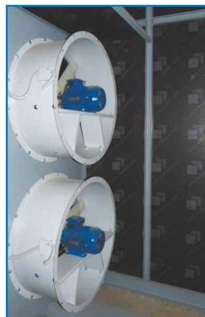
Напорные вентиляторы, установленные в МВК для навалного хранения, подают воздух в вентиляционный канал.
