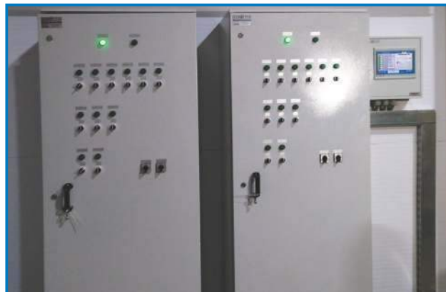
Шкафы управления и компьютерный модуль VENTOGLAS™ в хранилище оборудованном стеной обратного действия.
