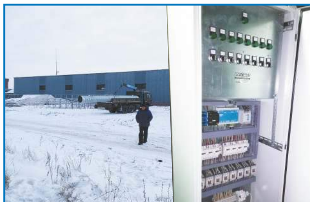
Шкаф управления напорными вентиляторами (дверь открыта).
