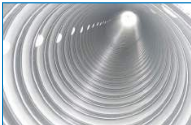
Воздуховод для вентиляции кагата (вид изнутри).
